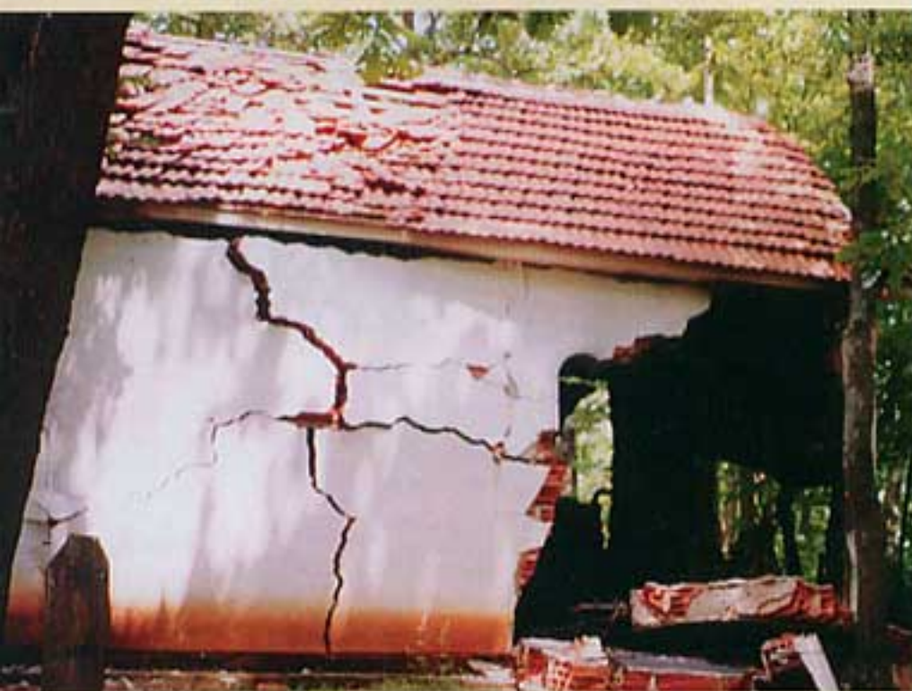
Blasted church Храм после взрыва мины.
