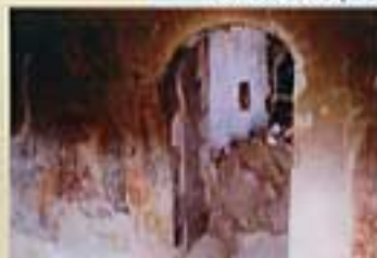
The church after blasting Храм после взрыва
